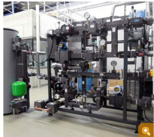
Funktionsmuster der von der TU Dresden entwickelten kombinierten Hausanschluss- und Netzeinspeisestation (HANEST) © TU Dresden, GEWV
