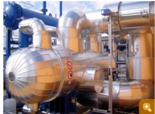
Verdampfer ORC-Prozess mit Abgaswärmezufuhr aus einem Gasmotor © Fraunhofer UMSICHT
